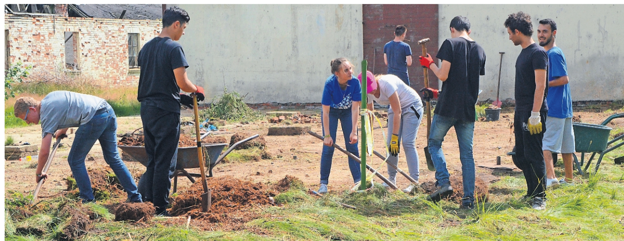
Auf dem neu zur Gedenkstätte zugekauften so genannten Edelmann-Grundstück gruben die Jugendlichen und jungen Erwachsenen die Fundamente von verfallenen Baracken frei.
