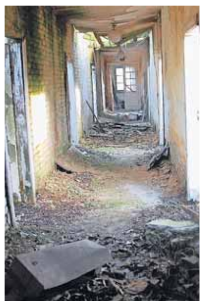
Der lang gestreckte Flur in einer der Baracken auf dem so genannten Edelmann-Grundstück, das mittlerweile der Stiftung gehört.
